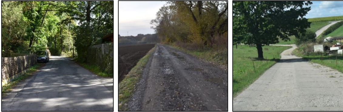
Abb. 5 Fahrbahnoberflächendefizite auf wichtigen interkommunalen Verbindungen
